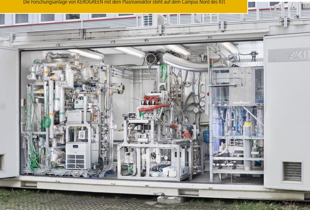
Die Forschungsanlage von KEROGREEN mit dem Plasmareaktor steht auf dem Campus Nord des KIT.
